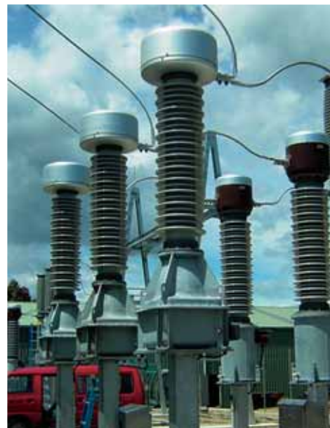
Transformadores de Tensión Inductivos de 123 kV. Electronet Services (Nueva Zelanda).
