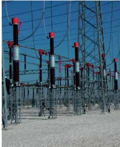
Transformadores de Tensión Inductivos de 420 kV. Rede Eléctrica Nacional (Portugal).
