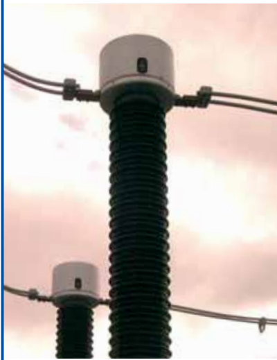
Conexión de "paso de corriente" en Transformadores de Tensión Inductivos de 245 kV.
